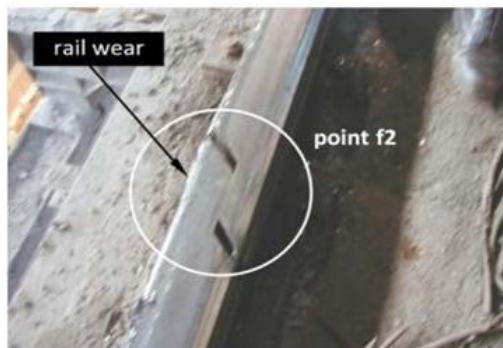
Gambar 5. Keausan yang terjadi pada rel [7]
