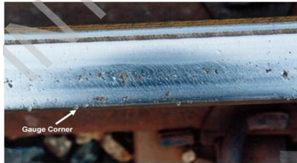
Gambar 6. Spalls yang terjadi pada rel [2]
