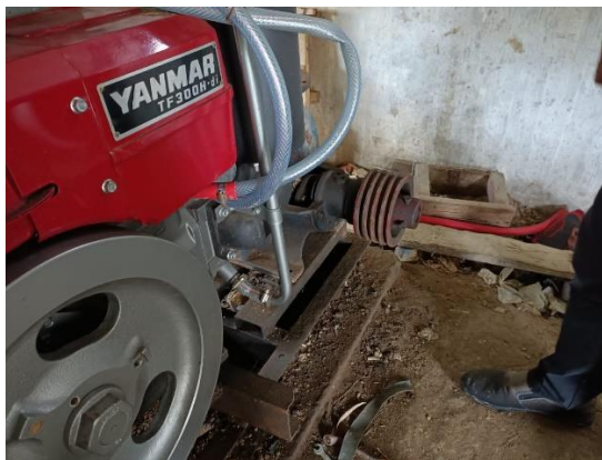
Gambar 1. Kondisi pompa tidak beroperasi
